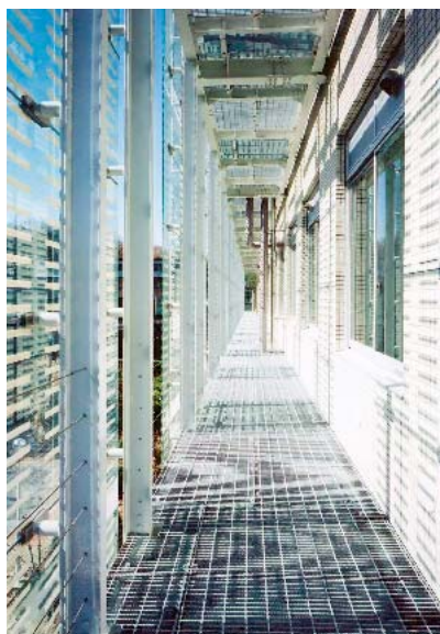
設備バルコニー
