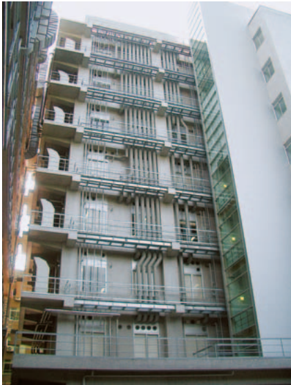
外壁北面実験排気ダクト
