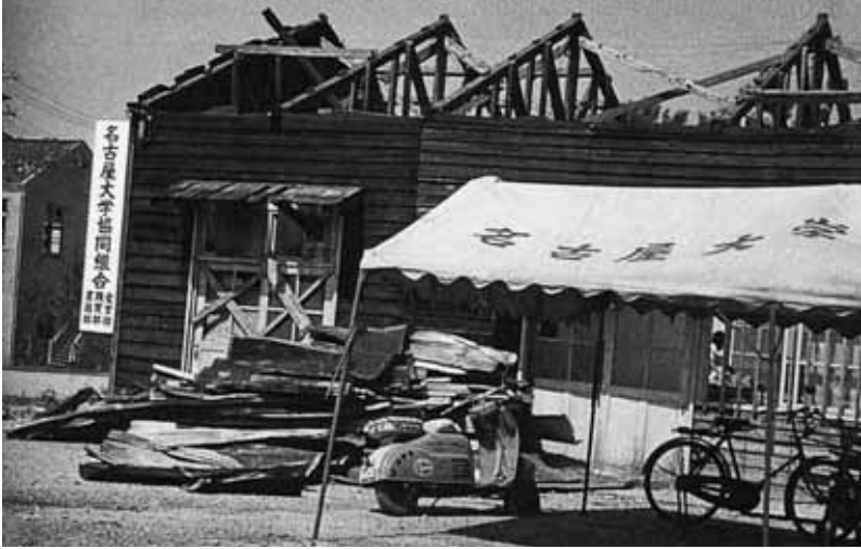
伊勢湾台風の被害を受けた建物
